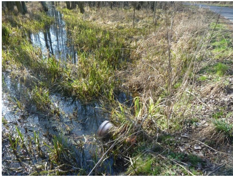
Abb. 8: Der Jordangraben mit dem unterdimensionierten Rohrdurchlass
